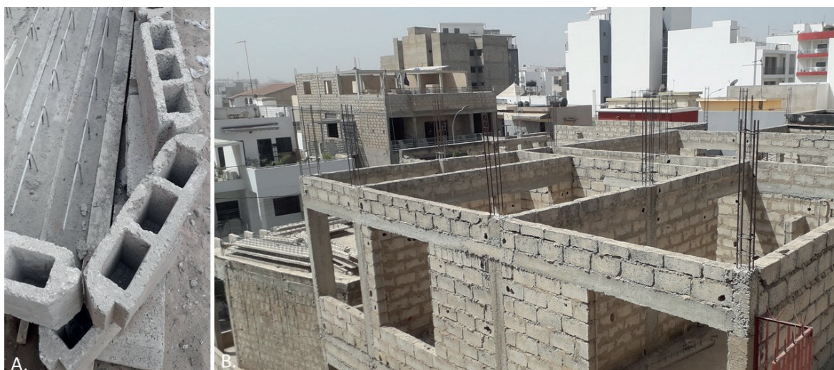
Ryc. 4. A. Standardowy system stropu gęstożebrowego prefabrykowany na budowie domu mieszkalnego, B. Budownictwo masowe wielokondygnacyjne stosujące małe rozpiętości charakterystyczne dla Sahelu Fot.: Sylwia i Marek Kulczyk, Saint Louis, Dakar, Senegal, luty 2022.
