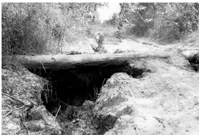
Fot. 4. Erozja poniżej belki zabezpieczającej drogę (fot. M. Szadura)
